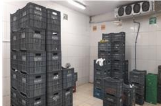
Pièce climatisée pour l'entreposage des légumes-racines entre le conditionnement et la livraison
