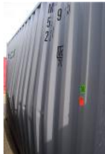
Рис. 7.68 Боковая стенка, поврежденная в ходе перевозки автомобильным транспортом
