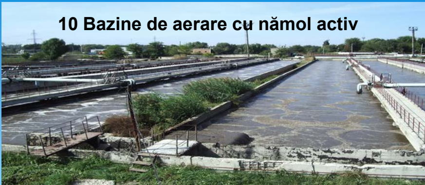
4 Decantoare secundare radiale (D 40 m, V-4500m 3 ) și 2 decantoare secundare radiale (D 50 m, V-4500m 3 )
