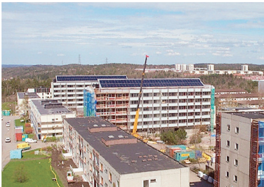
Фото 3. В Гардстене, Швеция, 1 400 м 2 солнечных батарей обеспечивают энергией около 500 квартир.
