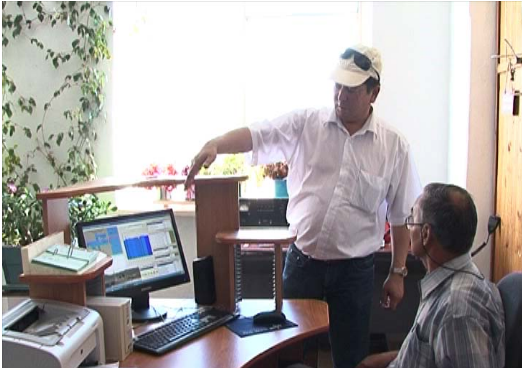
Западный Большой Чуйский канал: в диспетчерской...
